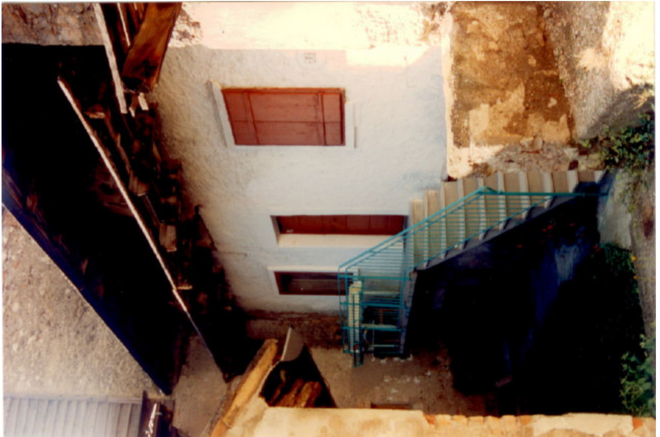
SCORCIO NORD EST (prima del risanamento)
